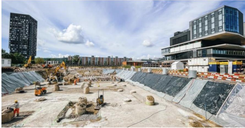
In Verbindung mit einer Wärmepumpe wird das Erdsondenfeld in Dübendorf laut der Forschungsanstalt rund 1,7 Mio. kWh jährlich zum Heizenergiebedarf des Campus Empa Eawag beitragen. (Foto: Empa)
