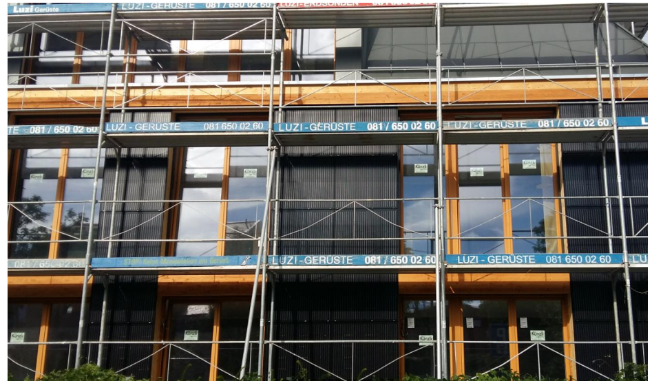
Quelle: AEV P.Müller, Fassadenintegrierte PV Anlage in Chur
