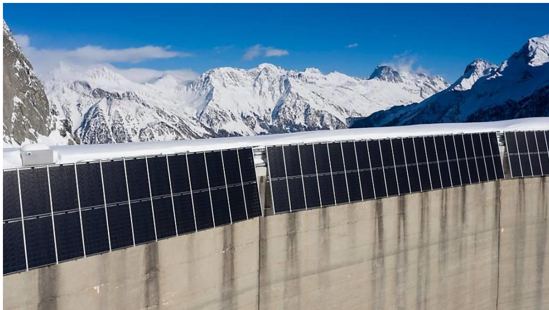
Hochalpine Solaranlage, Albigna-Staumauer, Bergell
